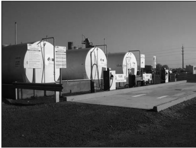
Figura 14. Vista del Depósito de Combustible.
