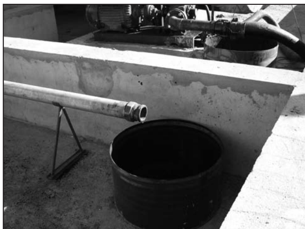
Figura 8. Bateas de contención de derrames.
