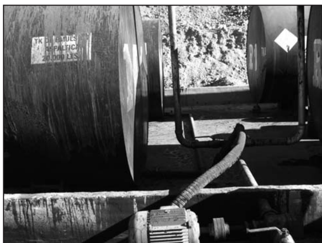
Figura 9. Instalaciones con derrames en cañería de distribución.
